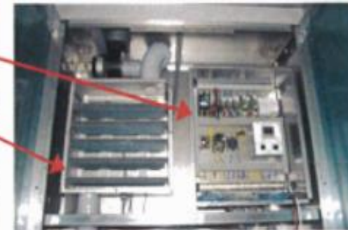
脱臭装置 制御盤
