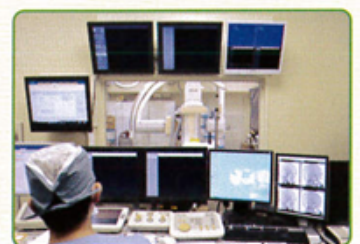
⑦ オペレーションルームにてX線遮蔽板をリモートコントロール
